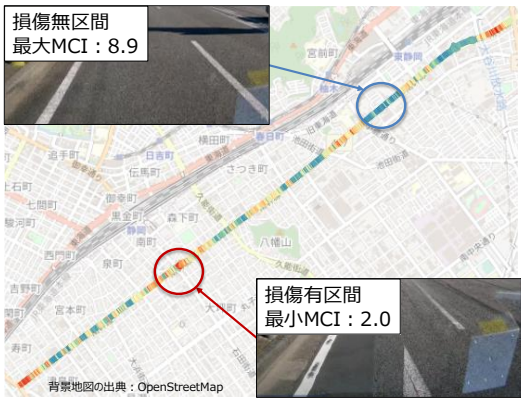
図-1 損傷無区間と損傷有区間
