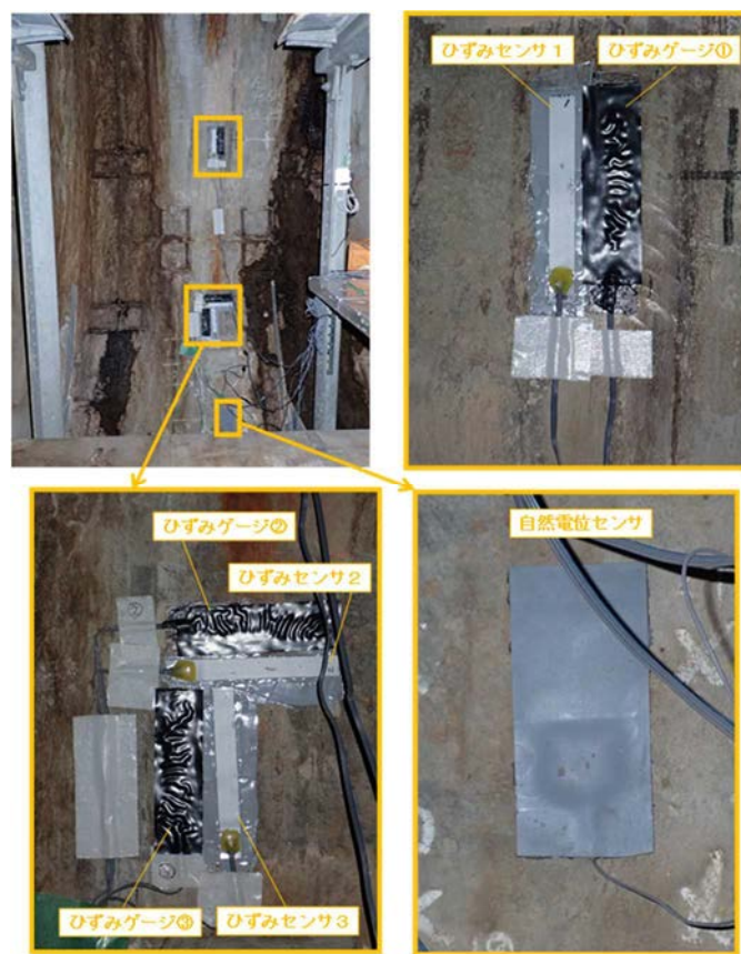
図 2 ひずみおよび自然電位センサ設置状況
