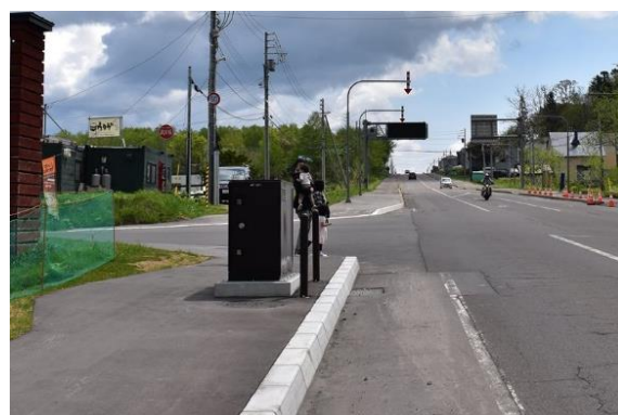
写真-1 望ましく無い地上機器の設置位置
