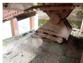
支承部の逸脱
