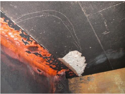
写真-1 橋梁火災による床版損傷例
