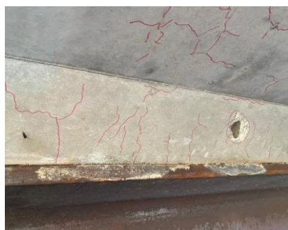
写真-1 加熱冷却後の床版状況
