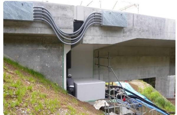
写真-1 従来の伸縮装置部通信管路設置例 いる（図-1）。
