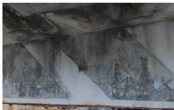
(a) 変状状況
