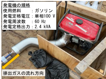
写真-1 排出ガスの回収構造
