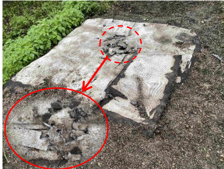
図-8 CCT2 の損傷状況
