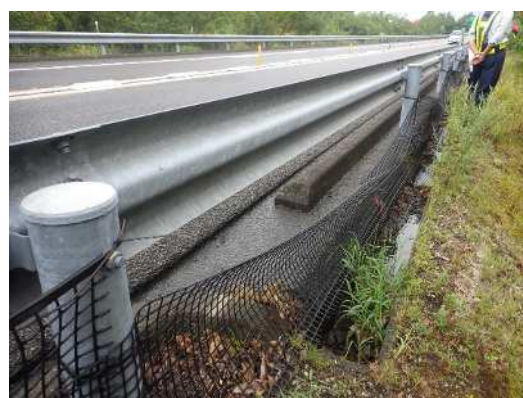
写真7 侵入対策の不具合
