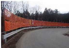
写真 5 遮蔽施設の設置状況
