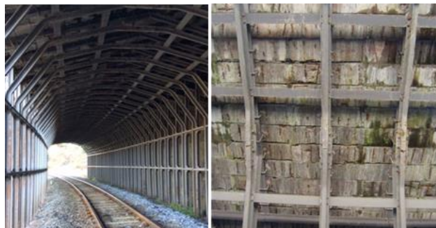
図・2 落石おおい工 床版劣化状況
