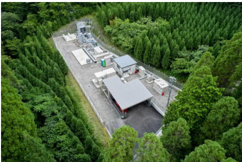
写真-4 地熱発電電力による水素製造プラント (大分県九重町)
