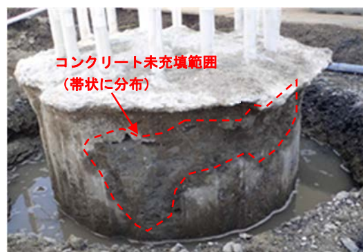
図-3 杭頭部コンクリート充填不良状況
