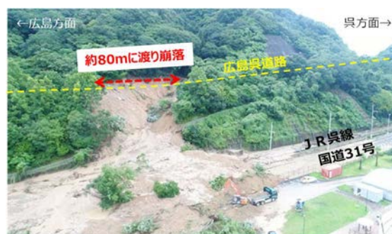
図-2 平成30年7月豪雨による大規模盛土崩壊
