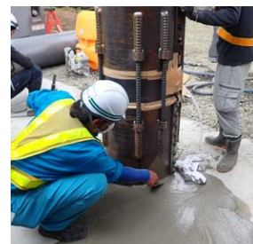
図-3〈モルタル漏出〉
