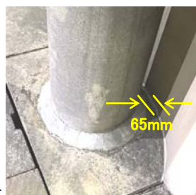
図-2〈電化柱背面の隙間〉
