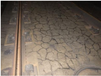
写真 1 スラブ上面の亀甲状のひび割
