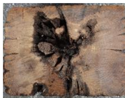
図-2 腐朽による空洞化
