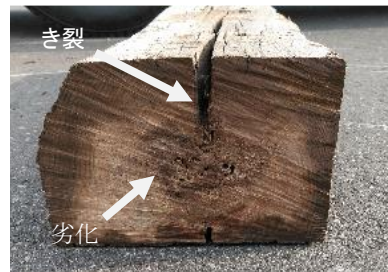
図-1 き裂による腐朽
