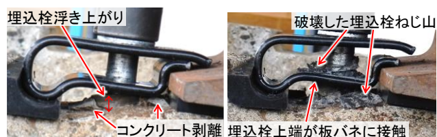
図 7 埋込栓破壊の状況
