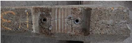
図 1 縦ひび割れの生じた PC まくらぎの例
