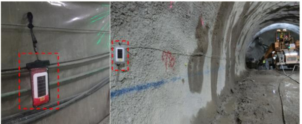
図-5 バッテリーレスビーコン設置状況
