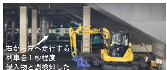
図-5 階段が支障して列車を誤検知した状況
