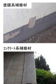
図-13. 補修補強材の損傷例
