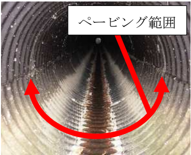
写真. 2 底面の発錆状況
