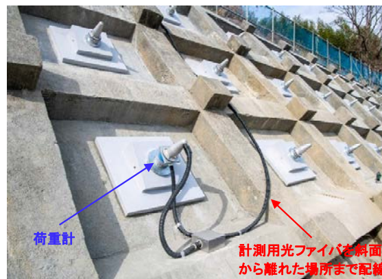
写真-1 本システムの実装状況
