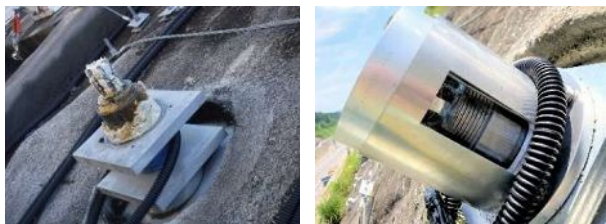
写真-1 (左) アンカーキャップ内部の変状例
