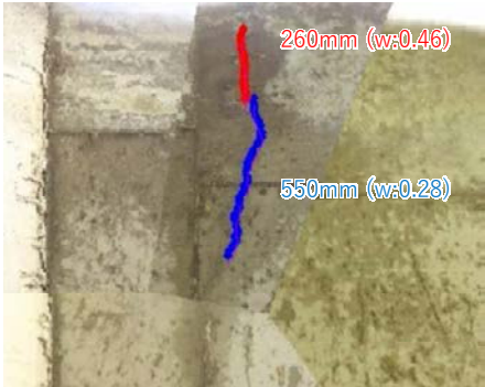
図4 ひび割れ自動検出結果
