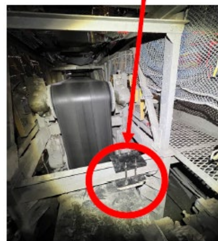
写真 3. RFID 読み取り機設置状況
