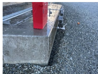
写真-1 地盤陥没状況
