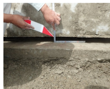
写真-3 基礎版下の空隙状況 (1-②地点)
