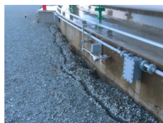
写真-2 ひび割れ状況
