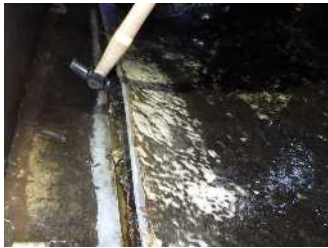
図 5 端部の剥がれ(A-2)
