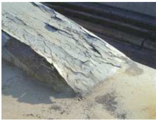
図 4 塗膜ひび割れ(C-1)
