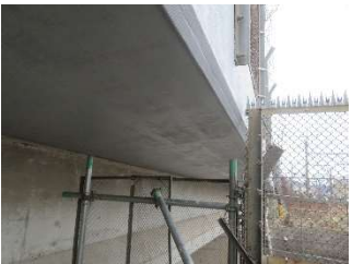
図-5 塗膜の外観
