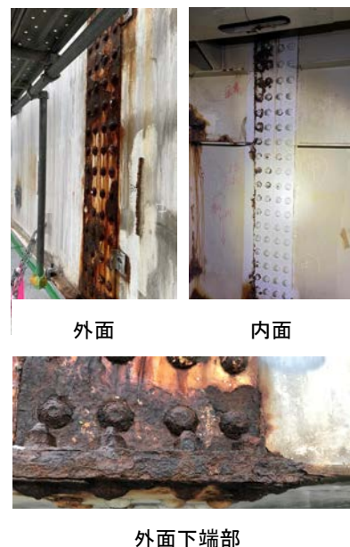
写真-1 添接部腐食状況
