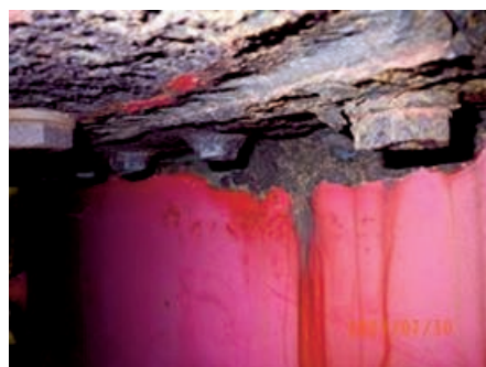
写真-2 メップ川橋腐食状況
