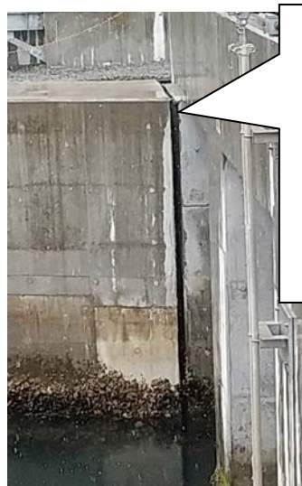
写真-4 令和4年度被災状況
