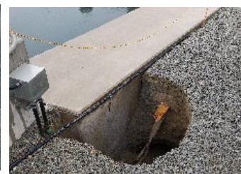
写真-3 令和4年度陥没状況
