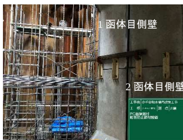
写真-3 転倒防止鋼材（側壁内面）
