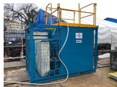
写真-7 温水コントロールユニット
