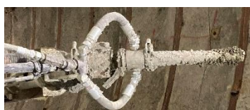
写真-3 シャワーリング添加システム
