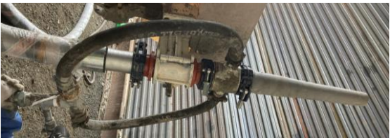
写真-1 シャワーリングおよびノズル
