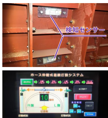
図-5 センサーと制御盤システム
