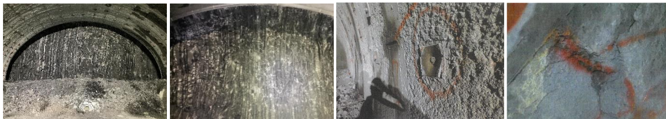
写真-1 切羽状況～ロックボルトプレート変形状況～吹付けコンクリートのクラック・浮き状況
