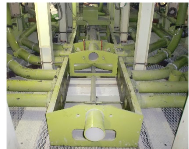
写真-3 多数配管切替装置の例
