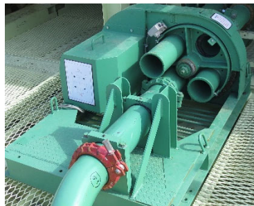
写真-2 4P 配管切替装置の例
