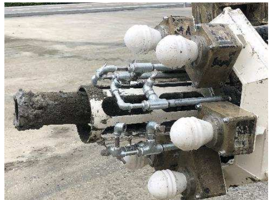
写真—3 エアー及び水洗浄装置 (対策④)
