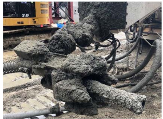
写真—2 コンクリート堆積状況
