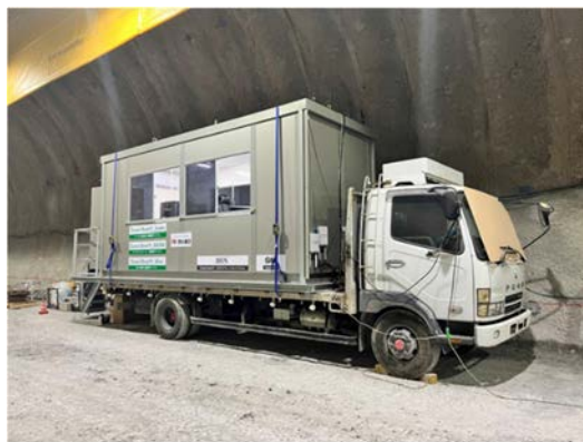
写真-1 遠隔操作室
