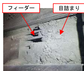
写真-2 フィーダーの目詰まり
