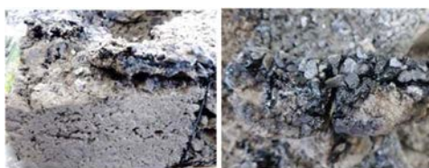
写真-3 試験終了時の損傷状況(断面)
