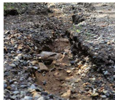
写真-1 路面浸食の例
