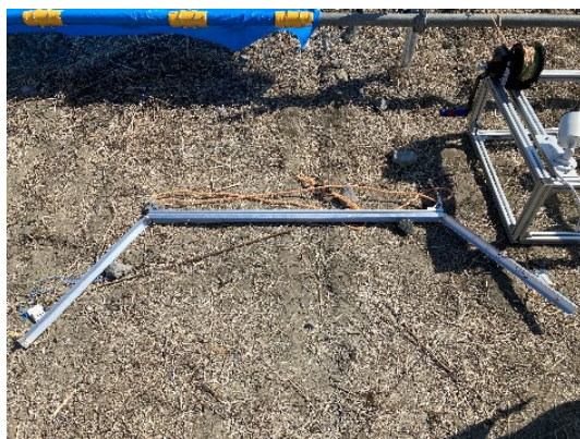
写真-3 強風で破壊した引張部材
