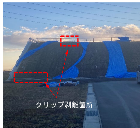
写真-4 クリップ剥離状況
