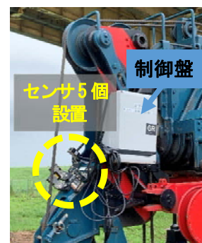
写真-1 機器設置例
