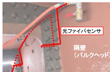
図-4 隔壁の配線箇所
