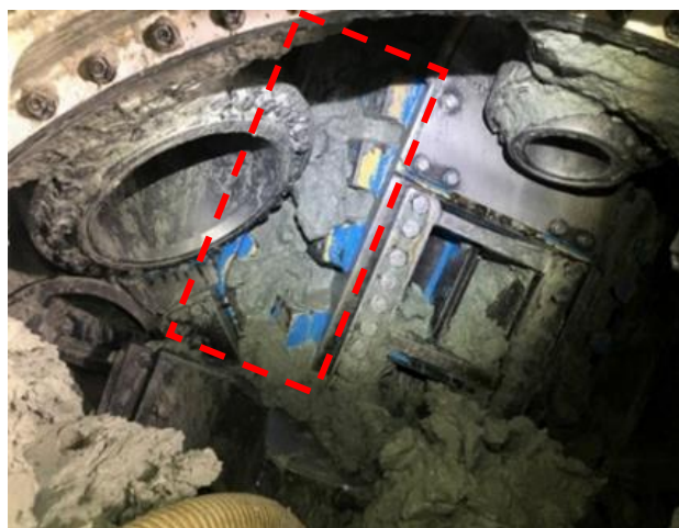
写真 1 スリット閉塞
