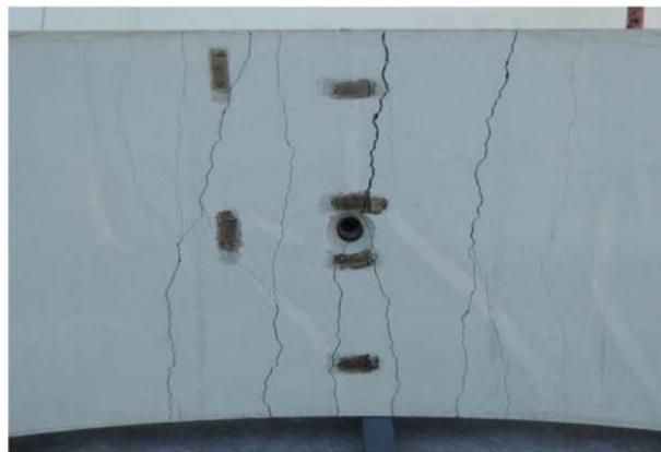
写真1 ひび割れ状況
