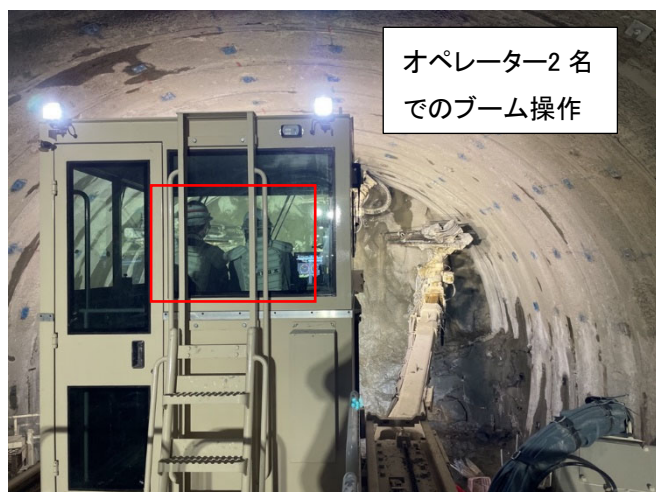
写真-1 穿孔状況
